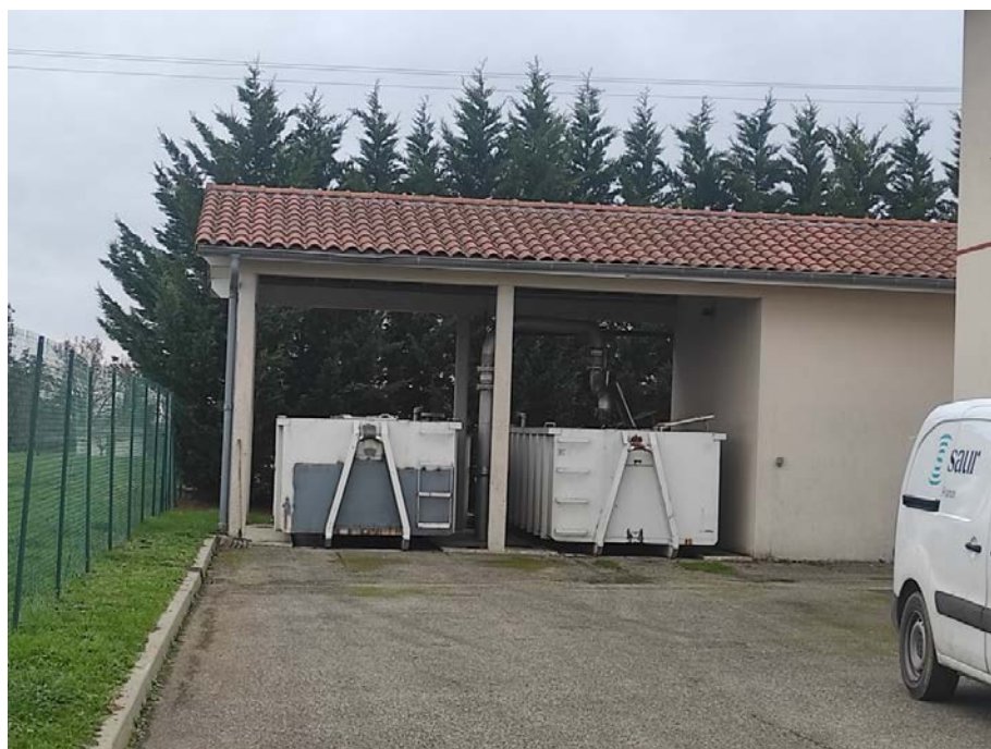
Figure 28 : Benne à boues (stockage sur la STEP de Beaumont-de-Lomagne)
