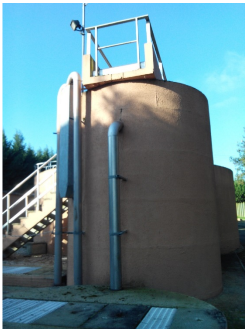
Figure 21 : Photo silo (source : ©ETEN Silo à boues de la commune d'Albias)
