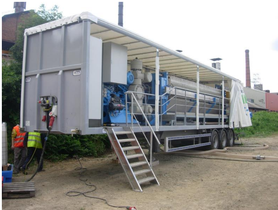
Figure 29 : Déshydratation mobile sur filtre-presse
