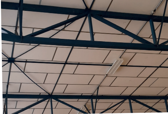
Nouvel éclairage au gymnase du collège Jean-Jacques Rousseau à Labastide-Saint-Pierre.
