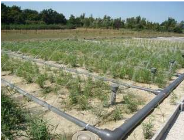
Station d'épuration filtres plans de roseaux
